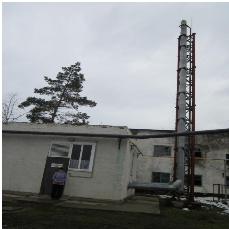
Рисунок Котельная № 13 посёлок Гончарка центральное теплоснабжение
