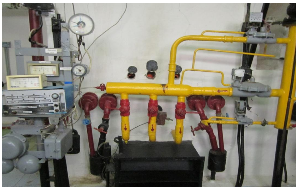
Рисунок: Котельная № 7 теплоснабжение местное
