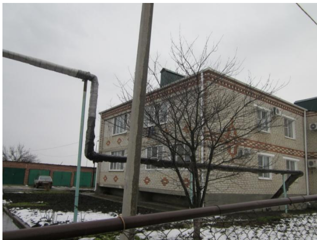
Рисунок; Теплотрасса теплоснабжения местное
