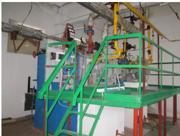
Рисунок; Котельная № 4, теплоснабжение местное
