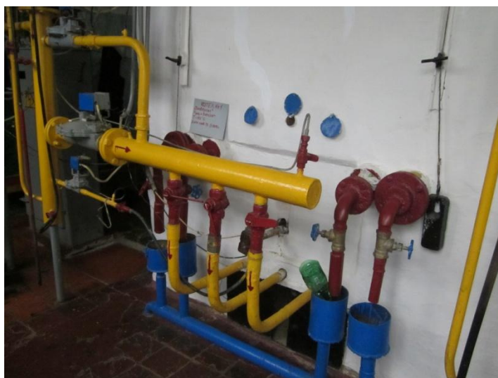
Рисунок; Котельная № 1 центральное теплоснабжение
