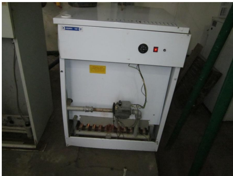
Рисунок: Котельная № 12 теплоснабжение местное
