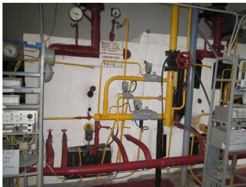
Рисунок: Котельная № 6 Теплоснабжение местное
