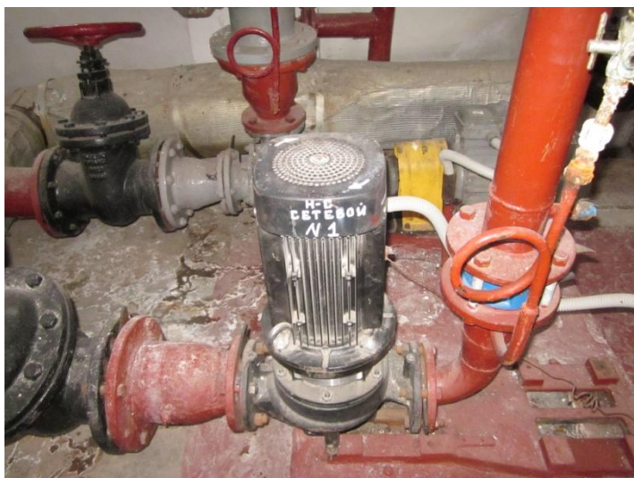
Рисунок: Тепловые насосы котельной № 4
